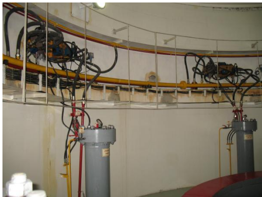
图 6 改造前的接力器管道
