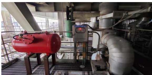
图5 炉前落煤管增加空气炮
