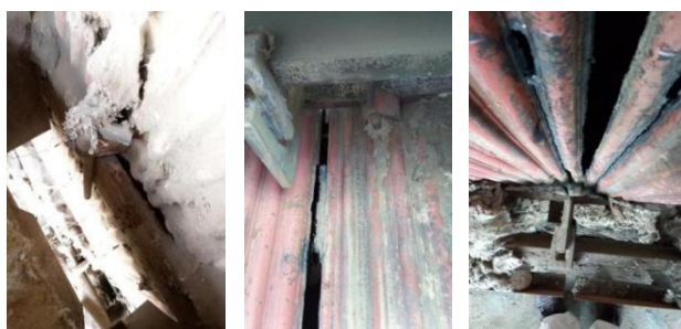
图 18 水冷壁开裂现场照片
